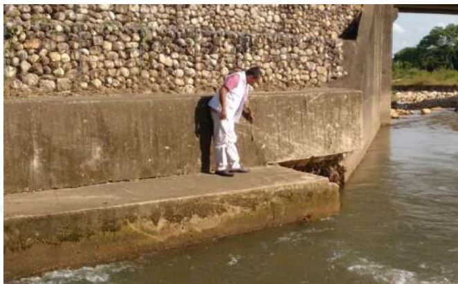
Monitoreo visual de las obras de protección (gaviones) del puente rio Guacharúa
